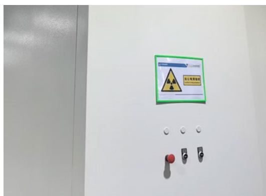
图 3-10 锂电环形 CT 铅房外部紧急停机按钮
