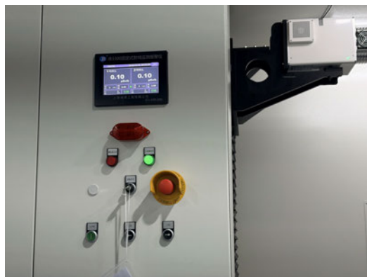
图 3-20 双立柱离线 CT 铅房外部 紧急停机按钮
