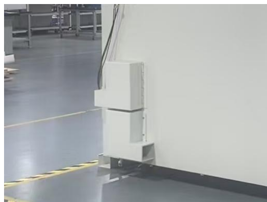
图 3-14 锂电环形 CT 铅房外电缆管道 铅防护罩
