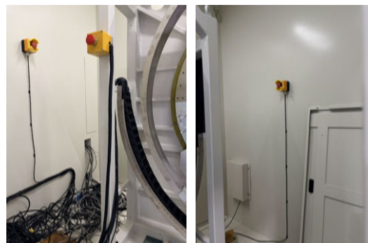
图 3-11 锂电环形 CT 铅房内部紧急停机按钮
