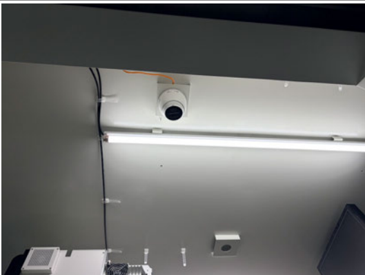
图 3-22 双立柱离线 CT 铅房内部监控探头
