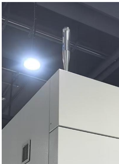
图 3-16 锂电环形 CT 铅房外 LED 三色警示灯
