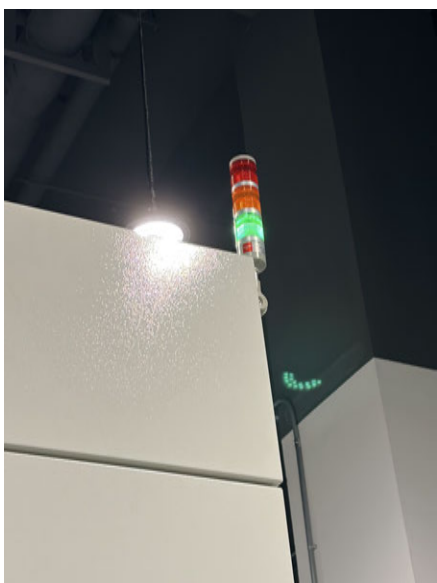
图 3-27 双立柱离线 CT 铅房外 LED 三色警示灯
