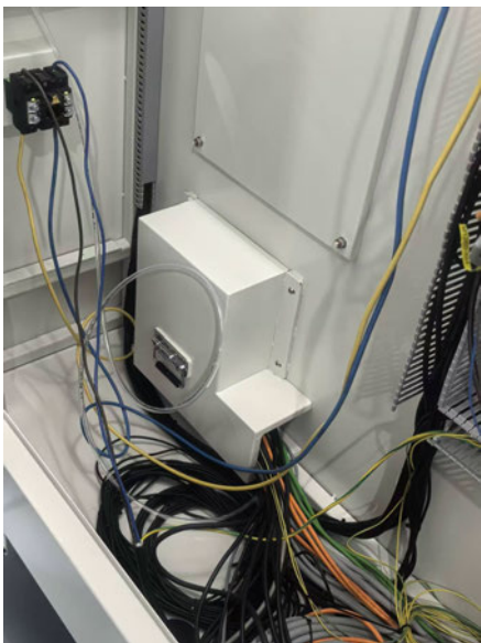
图 3-25 双立柱离线 CT 铅房电缆管道铅防护罩
