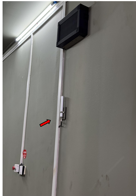
图 3-13 固定式场所辐射探测报警装置
