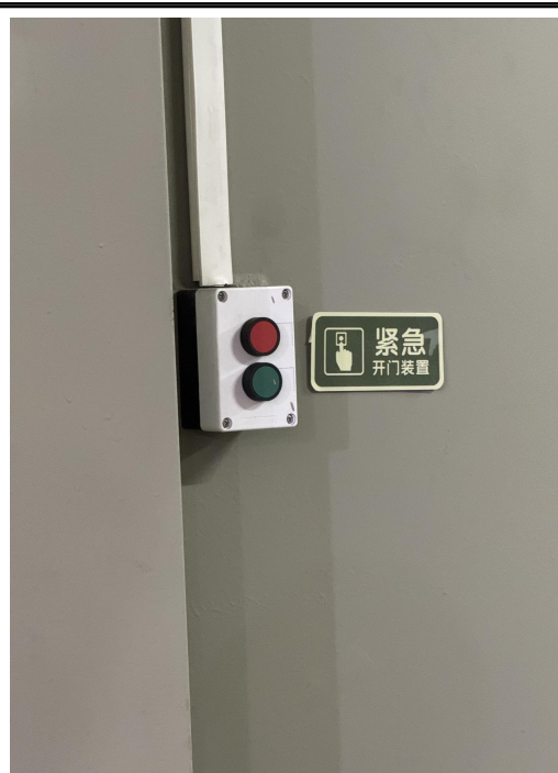
图 3-9 探伤室内东墙处北侧紧急开门装置
