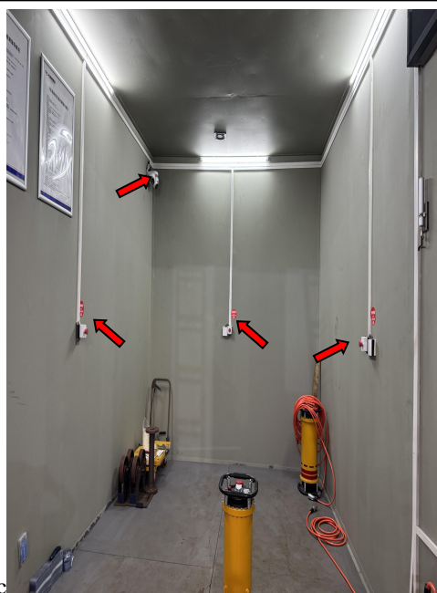
图 3-10 探伤室内（东、南、北，三个急停按钮；1 个监控装置）
