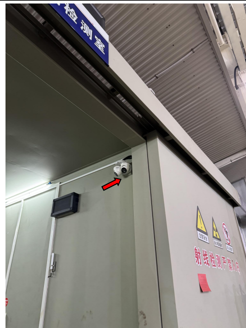
图 3-11 探伤室内西北侧监控装置
