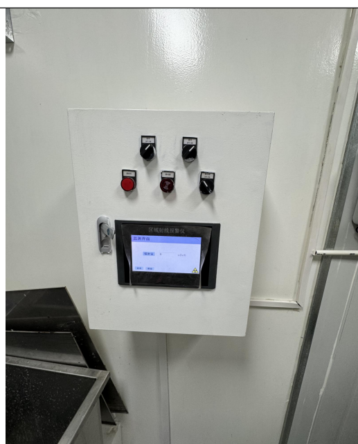
图 3-4 固定式场所辐射探测报警装置
