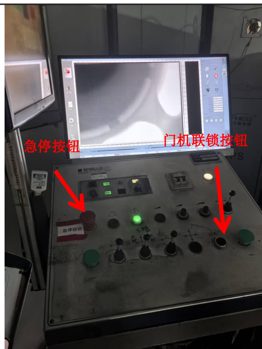
图 3-5 操作台（急停按钮、门机联锁按钮）
