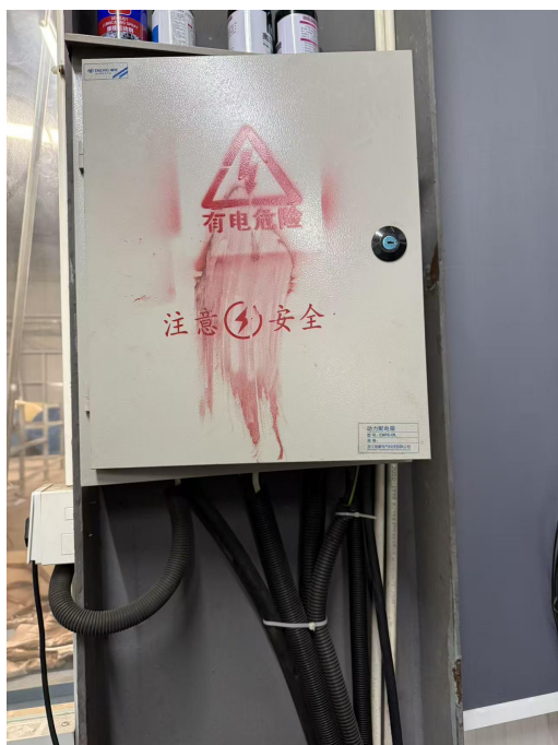
图 9 铅房电缆管线
