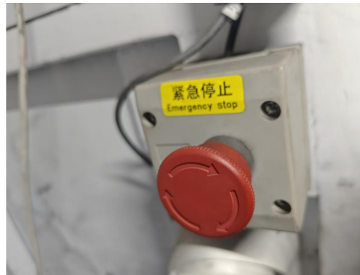
图 12 铅房内部急停开关
