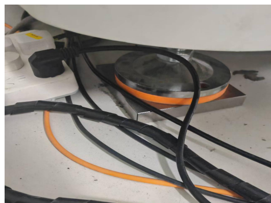
图 3-11 RMCT4000 型工业 CT 检测设备电缆孔
